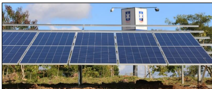
Figura 7: Módulos fotovoltaicos de 400Wp cada, com suas células solares em circuito misto, instaladas na UCS.
